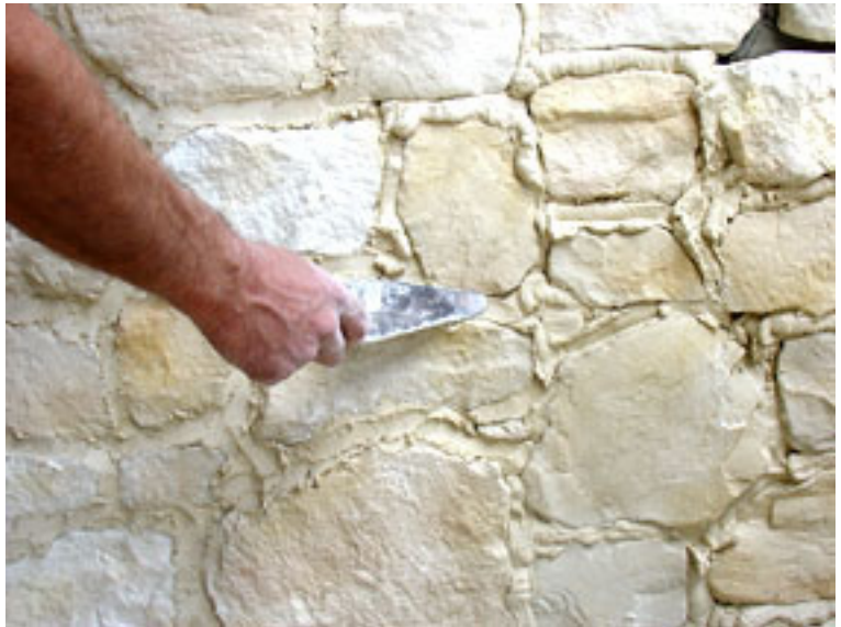
Serrez le mortier dans les joints afin de sceller complètement les pierres.
